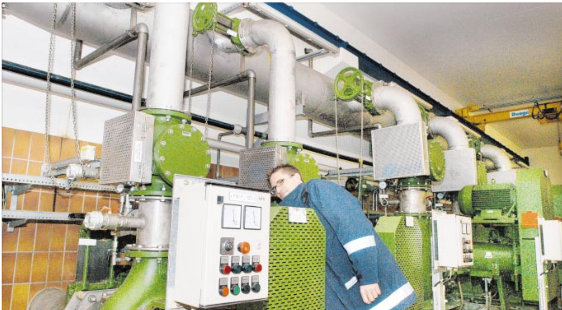
Da ist der Darmbach: Mit dem Abwasser der Stadt wird das Flüsschen durch große Rohre in die Kläranlage gepumpt – überwacht von HSE-Ingenieur Wolfgang John.
