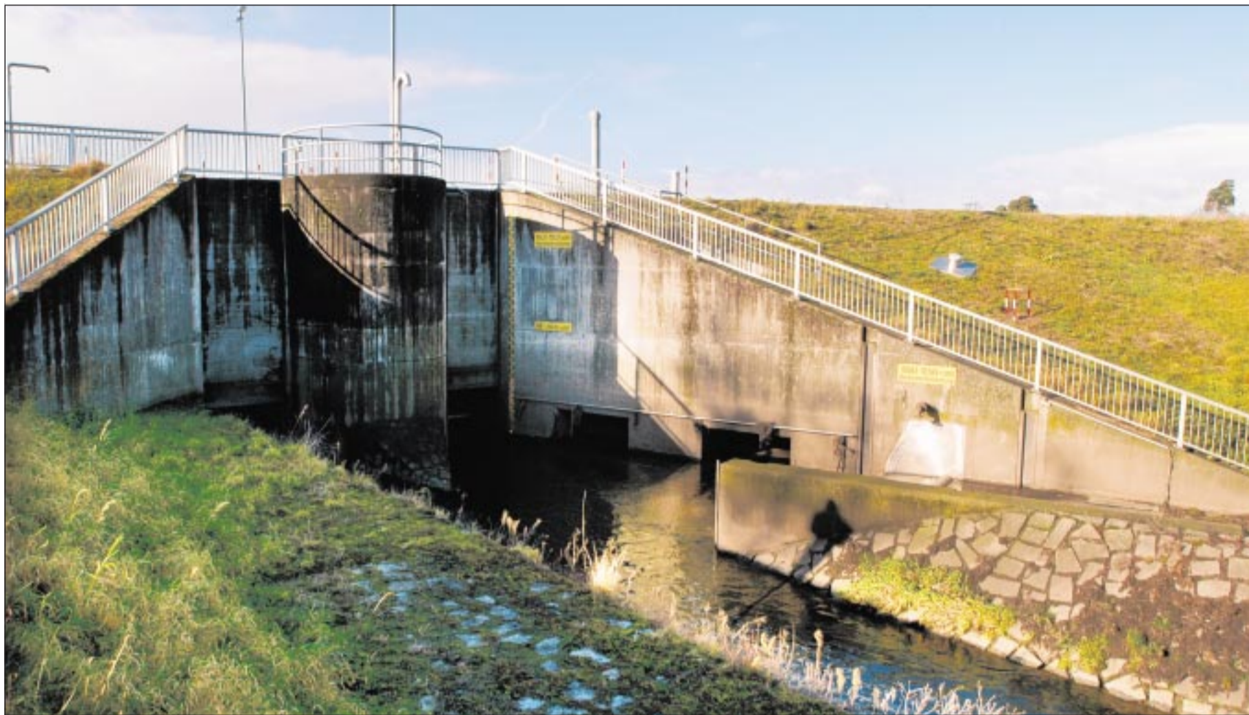
Auf Sylt? Nein, Deich und Sperrwerk liegen am Unterlauf des Darmbachs.
